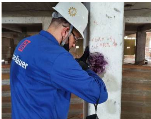
Figura 2. Exemplo de ensaio de profundidade de carbonatação em um dos pilares do Bloco 2.
