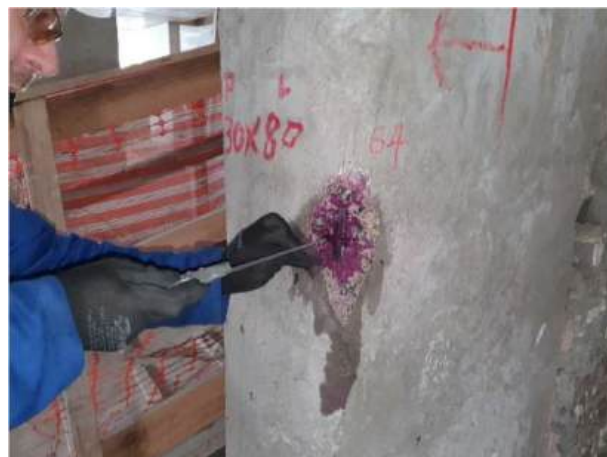
Figura 3. Aspecto do concreto após aplicação da fenolftaleína.
