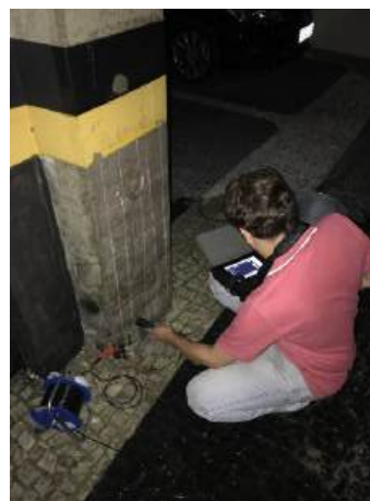
Figura 8. Ensaio de potencial de corrosão. Fonte: Elaboração própria
