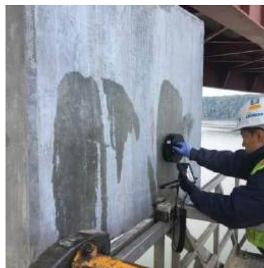
Figura 10. Estrutura saturada para o mapeamento da taxa de corrosão. Fonte: GIATEC SCIENTIFIC (2019)
