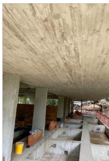
Figura 12. Concreto aparente com inibidor de corrosão em uma residência de alto padrão no Guarujá (SP).
