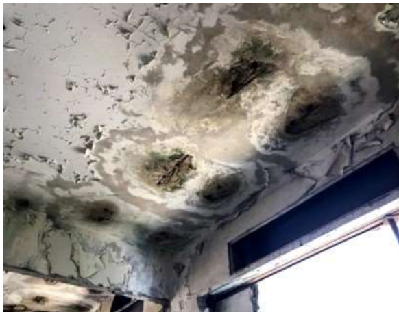
Figura 5 – Infiltrações e corrosão na estrutura existente. Fonte: Elaboração Própria
