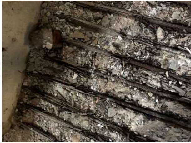
Figura 4 – Arranques existente corroídos com severa perda de seção. Fonte: Elaboração Própria
