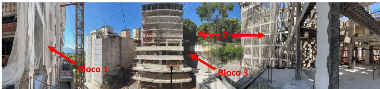
Figura 18 – Vista interna panorâmica dos blocos durante a execução do retrofit do Hotel Glória. Fonte: Elaboração própria
