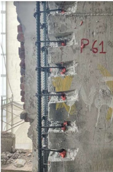
Figura 15a – Detalhe de ligação das barras novas de reforço de um dos pilares no Bloco 1. Fonte: Elaboração própria
