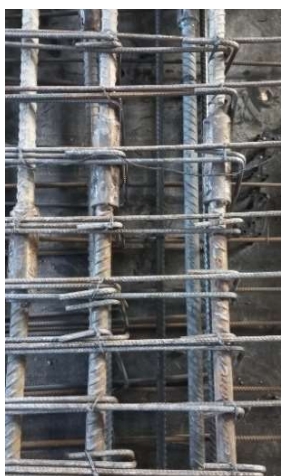
Figura 13 – Detalhe de ligação das barras novas de reforço dos pilares no Bloco 1. Fonte: Elaboração própria
