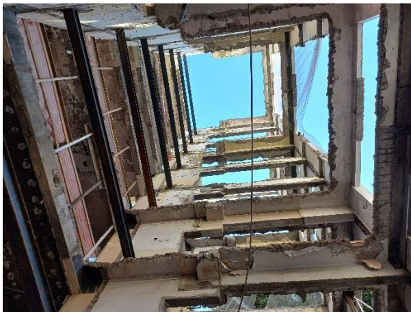
Figura 17b – Estrutura do Bloco 3 já sem as lajes originais. Fonte: Elaboração própria
