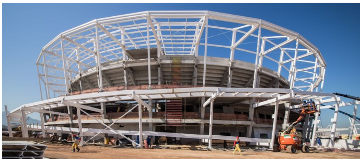
Figura 5 - Vista frontal da Arena do Tênis do Parque Olímpico do Rio de Janeiro durante a construção, gentilmente cedido por Monteiro Gomes Engenheiros Associados (2015).
